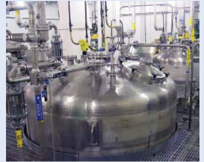
Tanques y reactores
